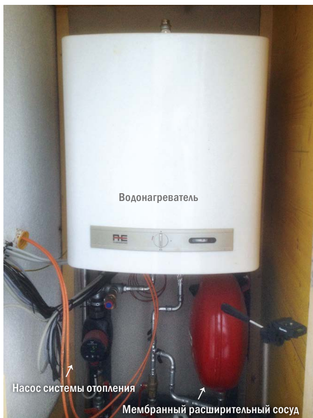
Техническое помещение с электрическим водонагревателем
